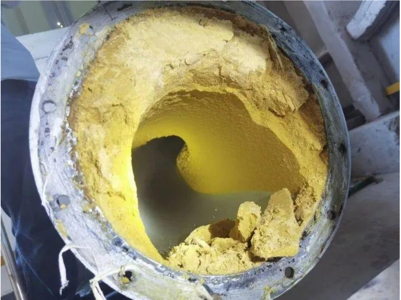
膨化大豆粉气力输送堵塞情况
