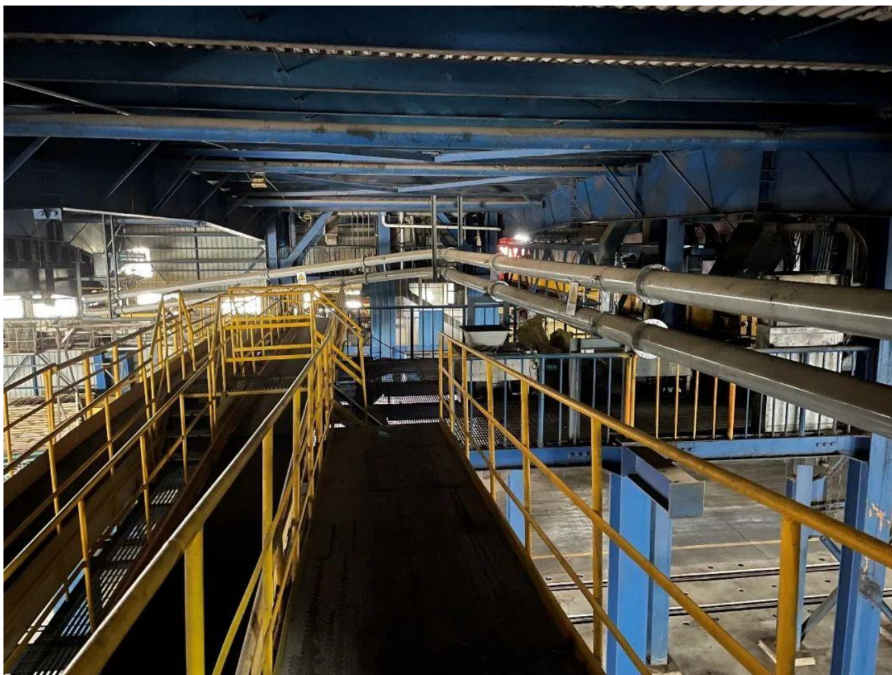
国内某知名集团客户管链机输送膨化大豆粉现场
